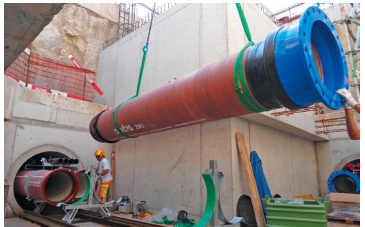
Auf der Einbauseite des Tunnels herrschten sehr beengte Platzverhältnisse. Im Bild: Montage eines Rohres auf die Transportschellen.
